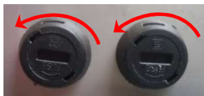
Figuur 22: Vervanging van de zekeringen
