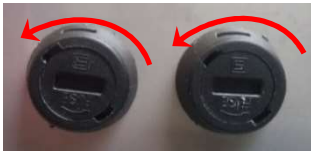
Figuur 22: Vervanging van de zekeringen
